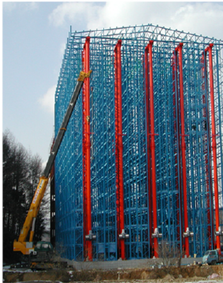
30M높이의 록 빌 자동창고 설치 사례
