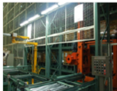
디버터 및 입출 컨베이어 흡포지선
